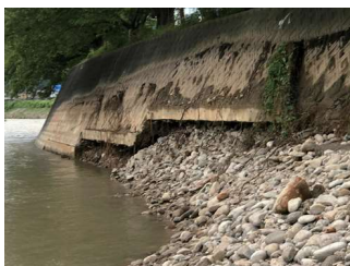
【道善区 那珂川の増水による護岸根露出】
