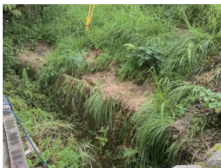
【別所区 林道からの雨水による法面崩落】
